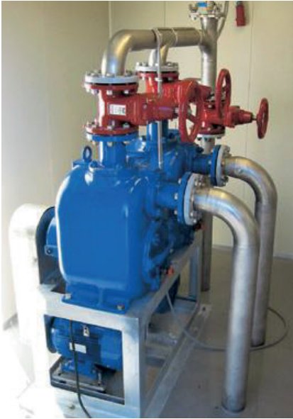
Maanpäällinen jäteveden pumppausasema
