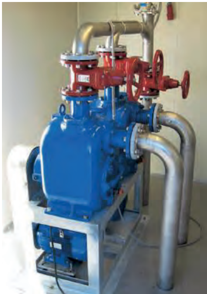
Maanpäällinen jäteveden pumppausasema
